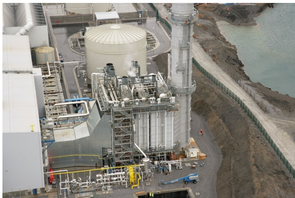
Рис. 1. Газотурбинная электростанция комбинированного цикла
